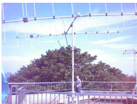
屋上に設置された移動アンテナV/U
